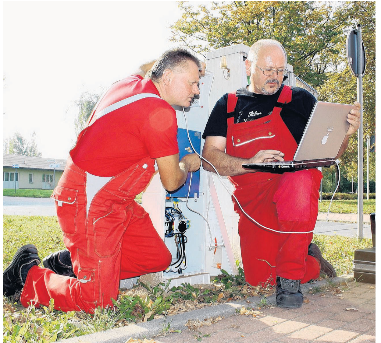
Die Runthaler Firma Elektro Schulze hat das Dimmlight-System im Industriepark installiert. Meister Holger Schulze (rechts) und Uwe Noack überprüfen an einer der zwölf Schaltstellen die Programmierung. FOTOS (2): TORSTEN GERBANK
