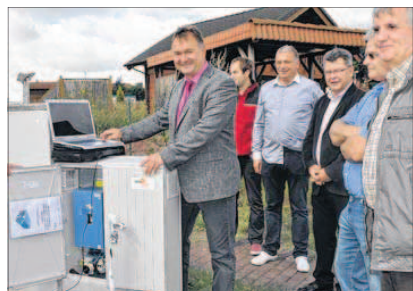
Bürgermeister Bernd Köppen setzt die Technik in Gang, die künftig das Straßenlicht zu später Nachtstunde dimmen soll und damit Stromkosten spart. Foto: Arlette Krickau
