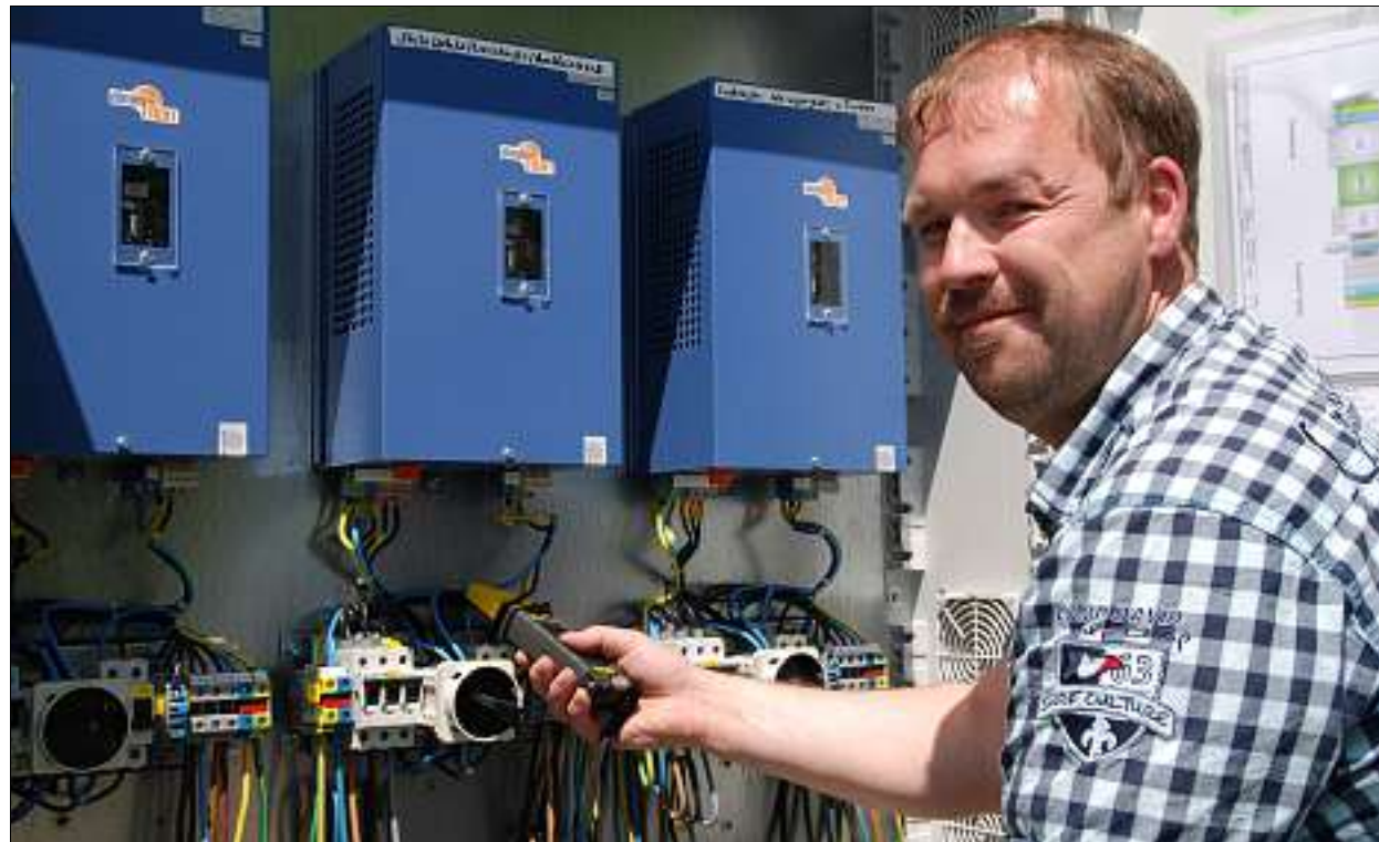
Jens Reinboth von der Firma EBA Elektro- und Beleuchtungsanlagen GmbH Artern beim Messen des Stromes an einem Dimmkasten nahe der Steilen Hohle in Artern Foto: Susann Salzmann
