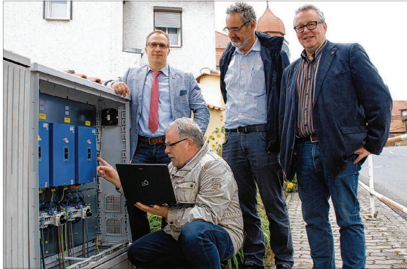
Vor dem Schaltkasten (von links): Oberbürgermeister Andreas Henke, Achim Schmidt (mit Laptop), Leiter der Abteilung Stadtbeleuchtung beim Stadt- und Landschaftspflegebetrieb, Abteilungsleiter Manfred Wegener vom Fachbereich Stadtentwicklung, Abteilung Tiefbau der Stadt Halberstadt sowie Ortsbürgermeister Ralf Barthel. Fotos (2): Holger Hadinga
